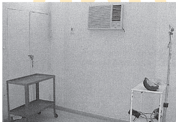
La salle d'accouchement climatisée
